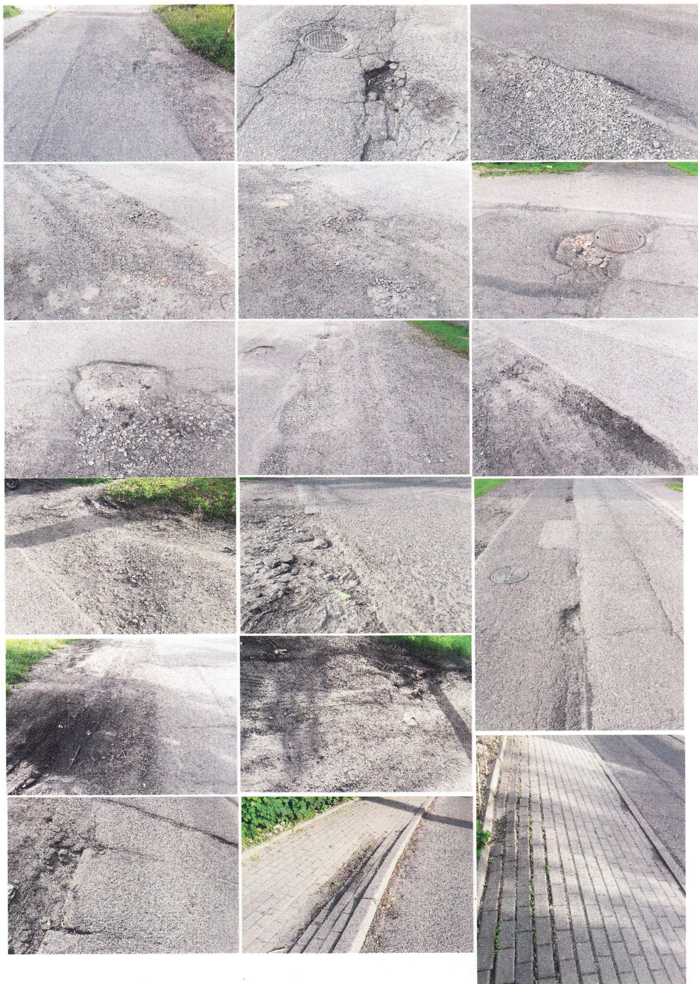
załącznik 2 do interpelacji w sprawie przebudowy ulicy Dolnej (warunki jakie panują na odcinku dwukierukowym ulicy Dolnej)
